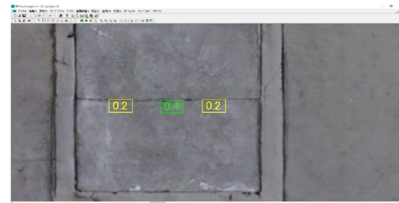
Step-3:画像上でひびわれをプロットして幅測定
