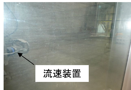
写真-12 流速装置(攪拌機)
