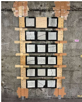
ひび割れパネル
