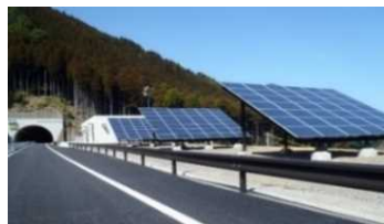
道路空間の太陽光発電設備
