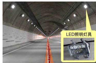
道路照明のLED化
