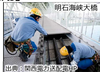
出典：関西電力送配電HP 送電網の収容に道路空間を活用
