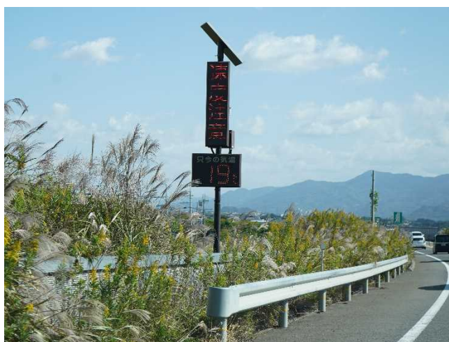
参考図 5-2 太陽光発電機能を有した道路情報管理施設の設置事例
