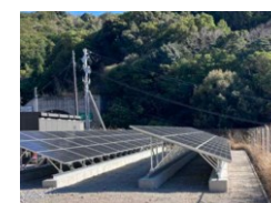
太陽光発電施設
