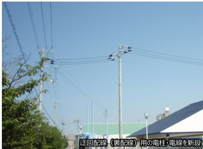
迂回配線（裏配線）の活用による無電柱化区間
