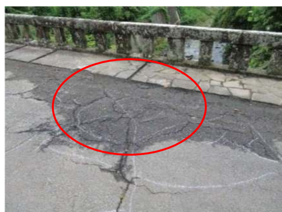
写真-2.6 路面のひびわれ
