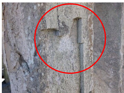
写真-1.1 板状剥離の発生事例
