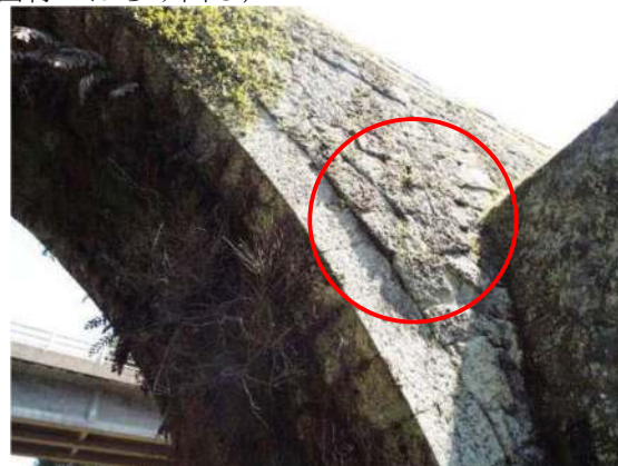
写真-2.4 壁面材のはらみ出し (2)
