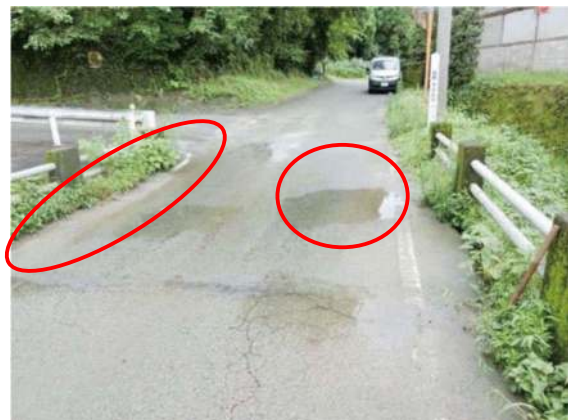
写真-2.5 路面沈下
