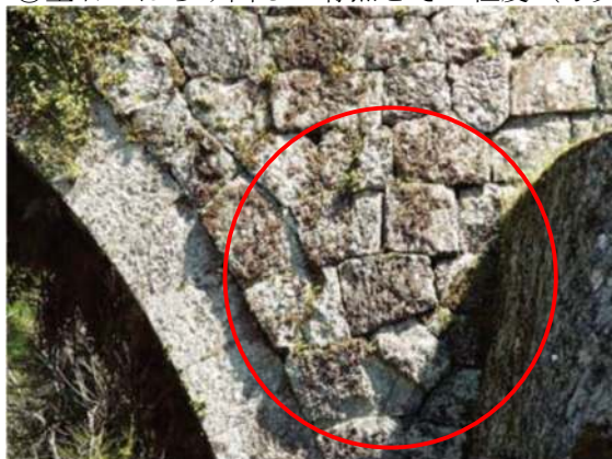
写真-2.3 壁面材のはらみ出し (1)
