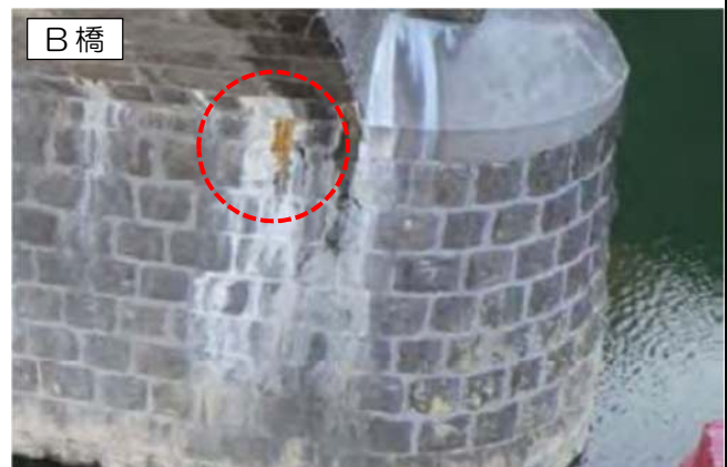
目地部分から漏水・目地材の流出
