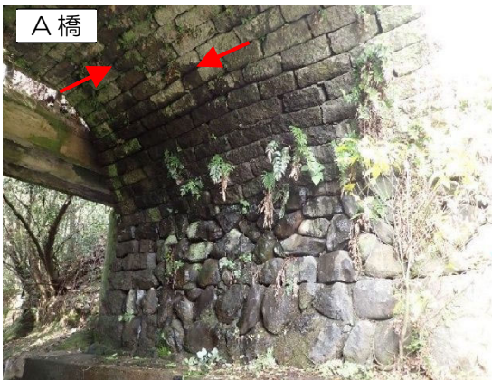
A 橋 輪石の複数箇所から漏水
