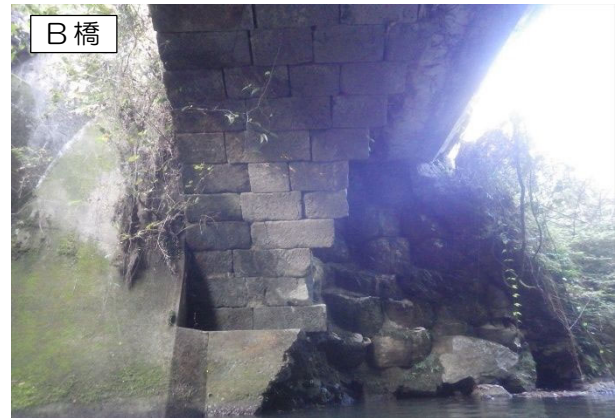
輪石が崩落し、荷重伝達がされていない
