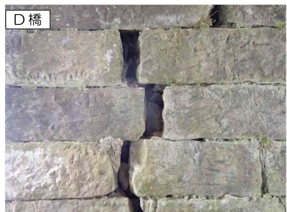
石材間の開き（隙間）により中詰材が流出
