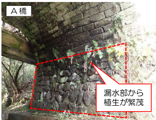
全体的に石材間から漏水
