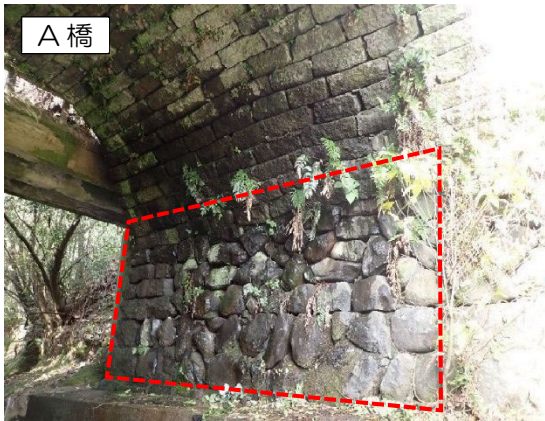
A 橋 全体的に石材間から漏水（空洞化の懸念）
