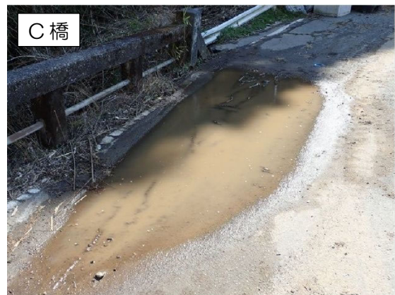
中詰の沈下による路面の異常、滞水
