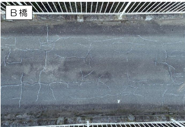
輪荷重載荷位置のひびわれ
