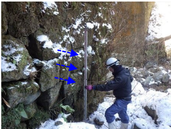
写真-付 1.1 壁石のはらみ出しの事例
