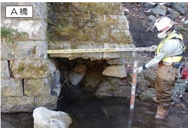
袖擁壁の底面が露出
