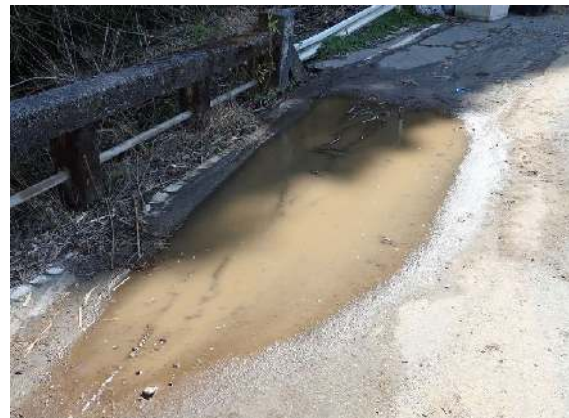
写真-付 1.2 はらみ出し位置の路面の凹凸
