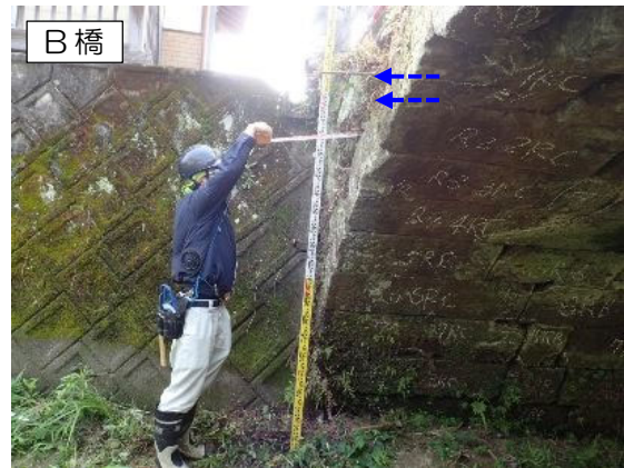
下側の壁石が外側に変位
