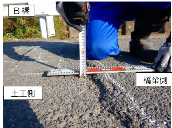
B 橋 橋梁と背面土工との境界の段差
