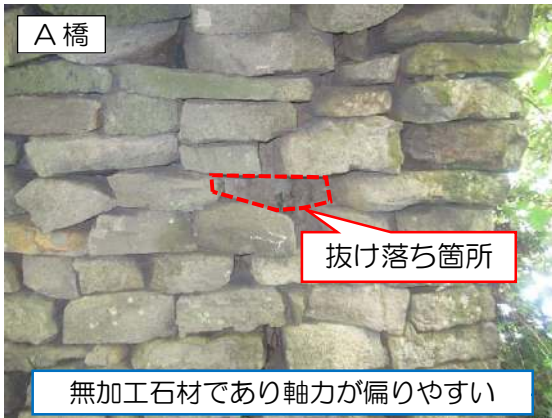
輪石の一部が抜け落ち
