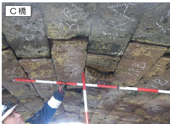
アーチ頂部付近に抜け出しと開きが発生
