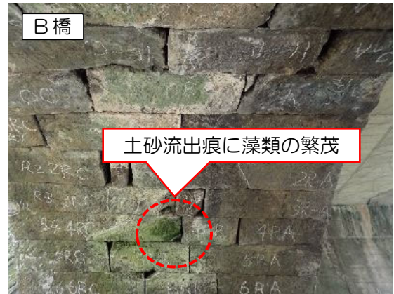
B 橋 輪石下面に藻類繁茂（空洞の懸念）
