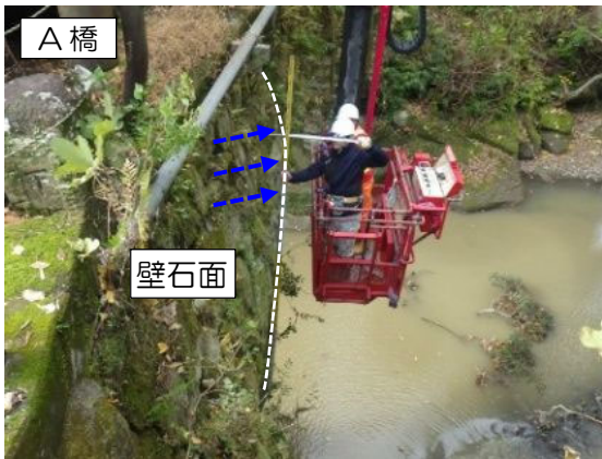
上端の壁石が外側に変位
