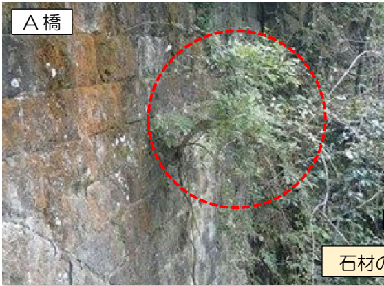
壁石の石材間に樹根貫入
