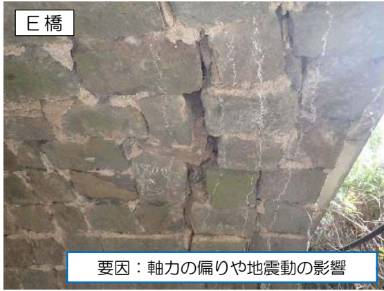
石材間の隙間により中詰材が流出
