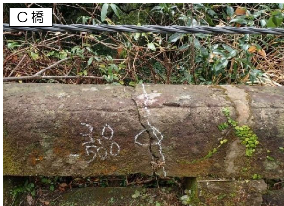
石材高欄の一部が破断
