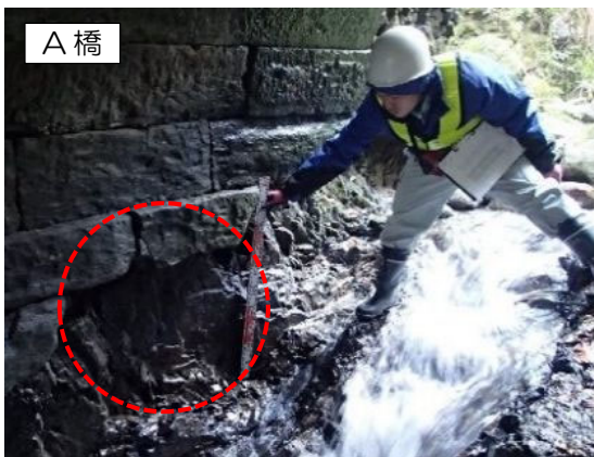
洗掘により輪石下端風化部分の流失
