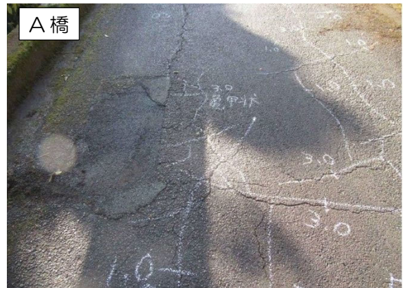
亀甲状ひびわれ
