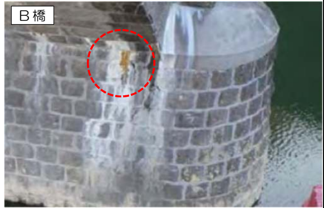
B 橋 目地部分から漏水（空洞化の懸念）
