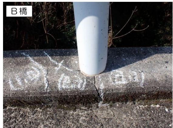
高欄基部コンクリートにひびわれ
