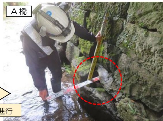
河川流により下部構造の変状が進行
