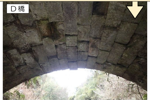
複数の抜け出し（5cm 以上ずれている箇所あり）
