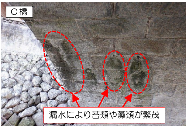
C 橋 輪石の複数箇所に漏水跡
