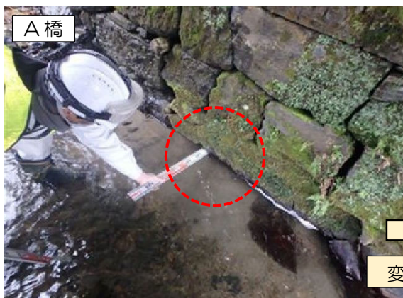
移動・傾斜により河床と下部構造に隙間
