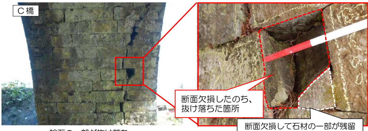
輪石の一部が抜け落ち
