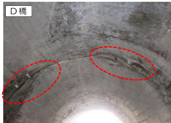
D 橋 補修した輪石下面から漏水跡
