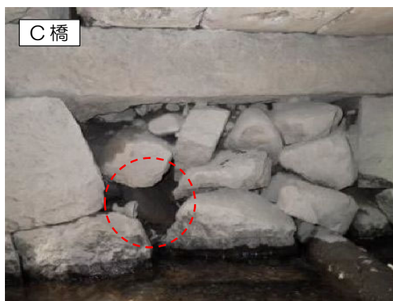
抜け落ち・石組の崩れ
