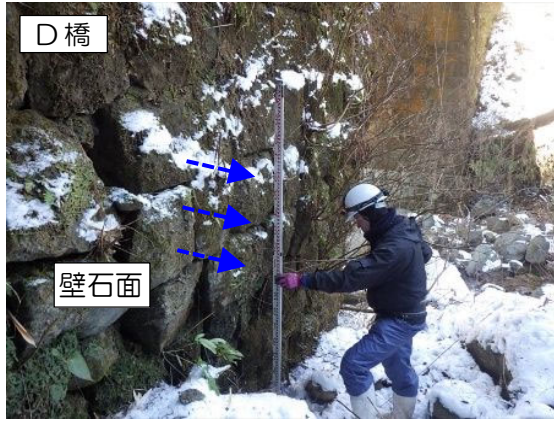
壁石面が外側に大きく変位（上側 7cm 程度）
