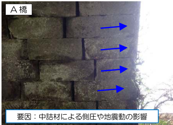
石材間の開き（隙間）（直角方向に変位）
