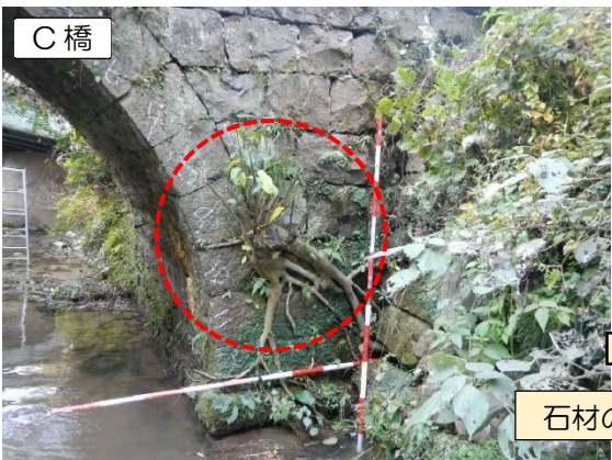
輪石、壁石間に樹根貫入
