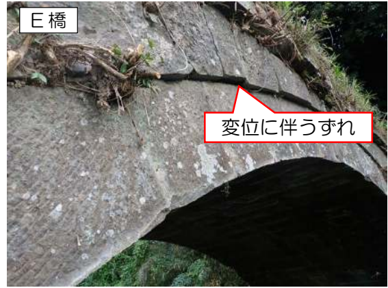
輪石上部の壁石が外側に変位
