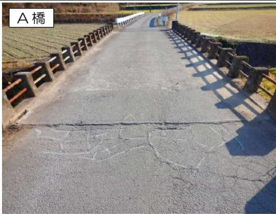
A 橋 橋梁と背面土工との境界の段差
