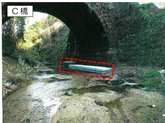
C 橋 対策範囲（コンクリートによる橋台基礎部の補強）
