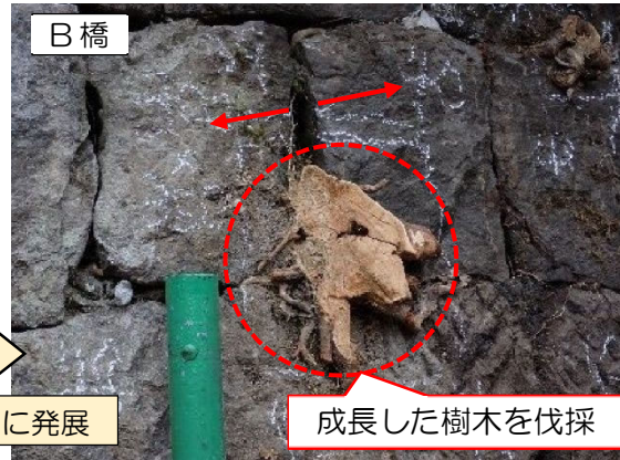
樹根貫入による石材の開き
