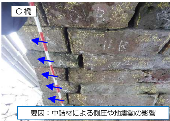
石材間の開き（隙間）（直角方向に変位）
