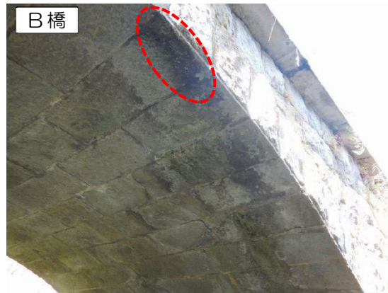
B 橋 輪石下面の一部に漏水跡
