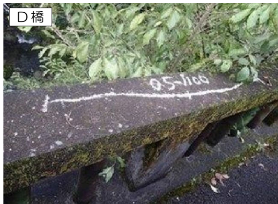
コンクリート高欄の一部にひびわれ
