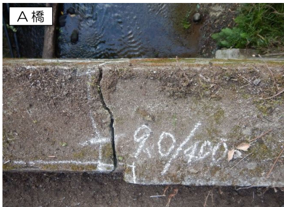
地震により地覆に破断が発生
