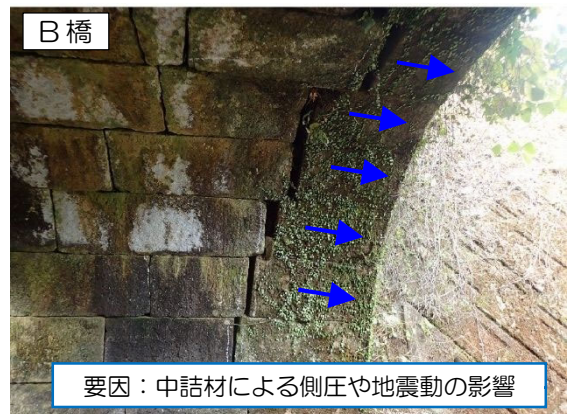
石材間の開き（隙間）（直角方向に変位）
