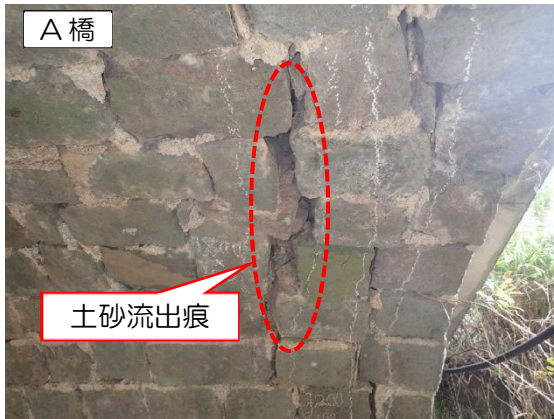
A 橋 輪石下面の開き・土砂流出痕（空洞の懸念）
