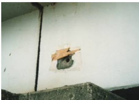
写真8 PC 定着部の損傷 （堤防から橋桁の側面を見る）
