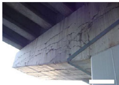
写真9 下部工のひびわれ （河原から下部工を見上げる）
