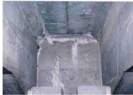
写真5 横桁のひびわれ
