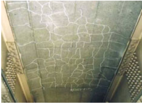
写真4 床版ひびわれ
