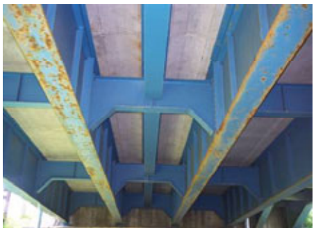
写真6 主桁の腐食 （河原から橋の下面を見上げる）
