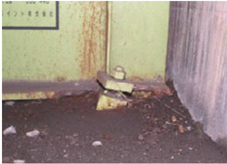
写真2 支承の機能障害
