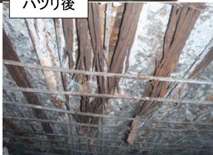
※写真はPC桁下面のひびわれ事例
