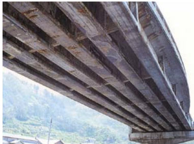
※写真はPC桁下面の損傷事例
