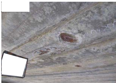
※写真はPC桁下面の損傷事例
