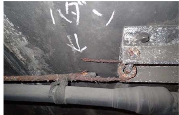
破断した取付部材
