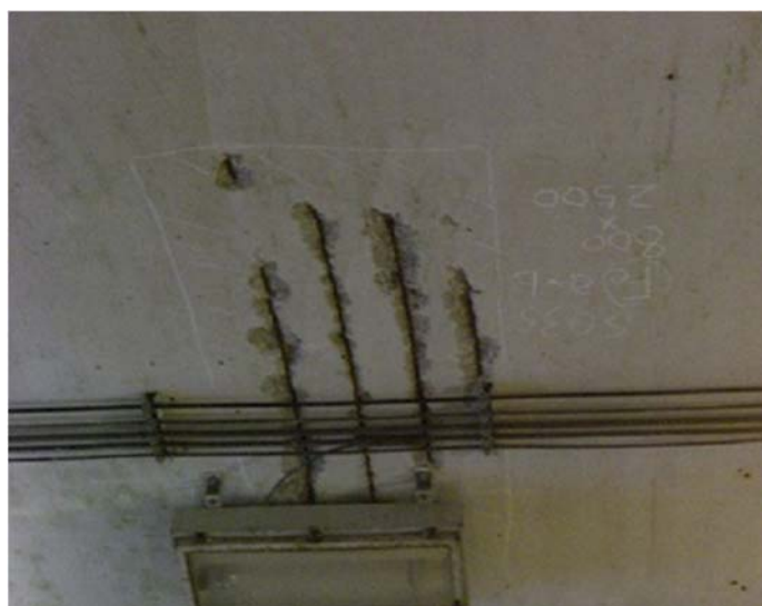
付写真-3.1.2 鋼材腐食の例
