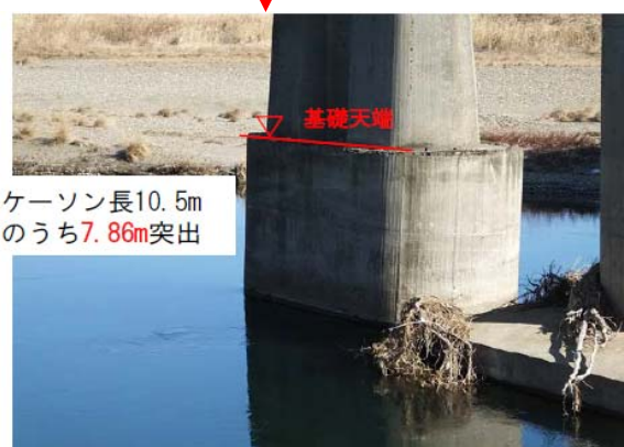
P8橋脚ケーソン基礎の洗掘状況
