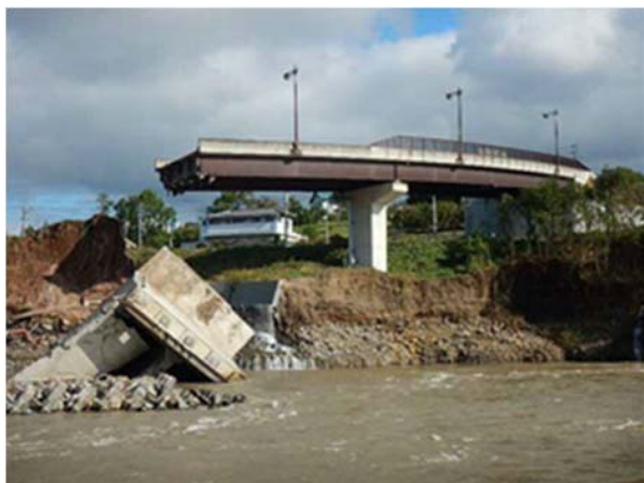
橋台の流出 橋脚基礎の洗掘
