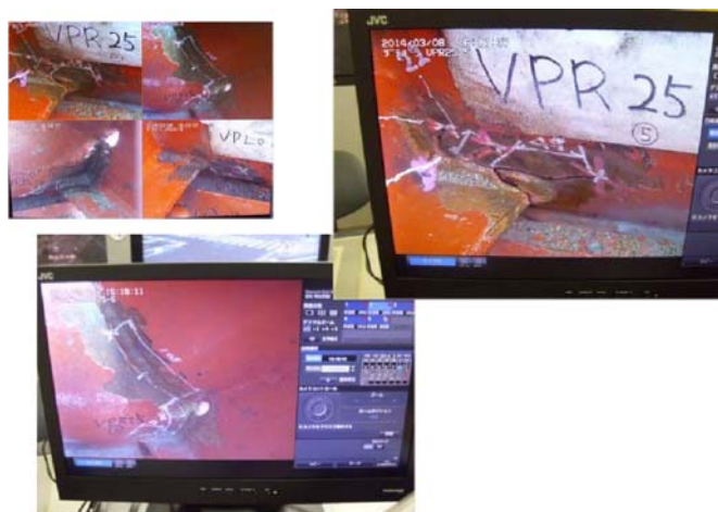
①橋台部の亀裂把握(画像)
