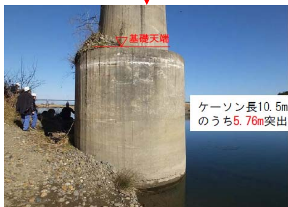
P7橋脚ケーソン基礎の洗掘状況
