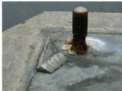
図－６．２ 転用部材のアンカーボルトの変状事例
