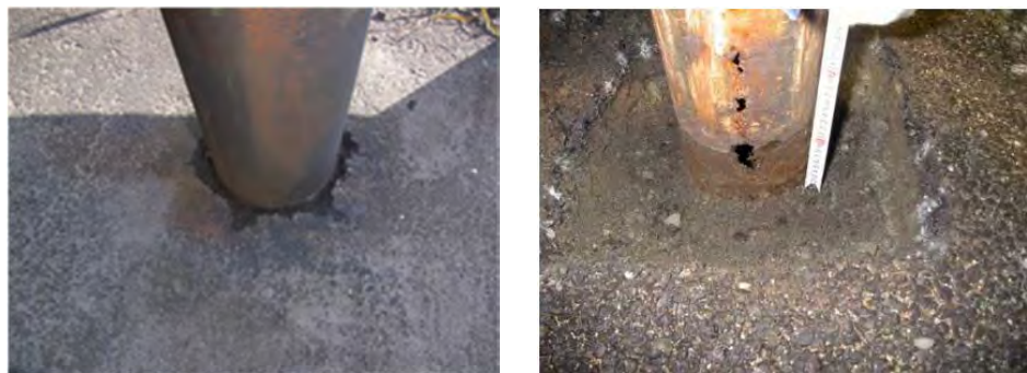
（腐食，路面付近での滞水や錆汁）
