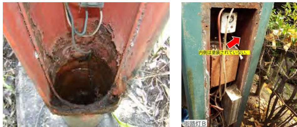
図－２．１．４ 電気設備開口部の損傷例
