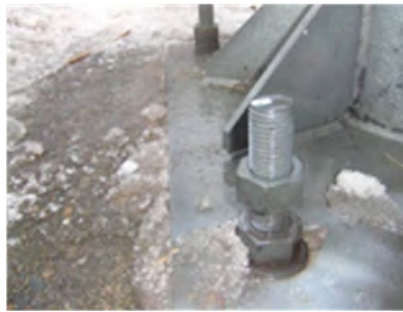
図－６．１ 設置後１年程度の附属物のアンカーボルトのゆるみ
