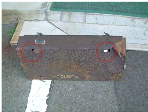
落下照明背面状況
