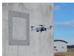
ドローンによる損傷把握
