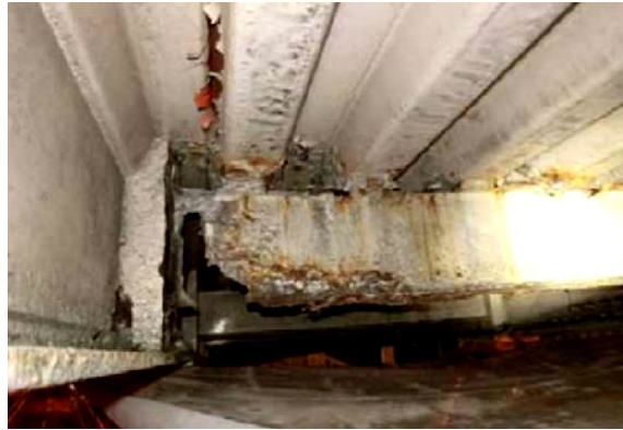
図 1.1.3 漏水による横桁の損傷
