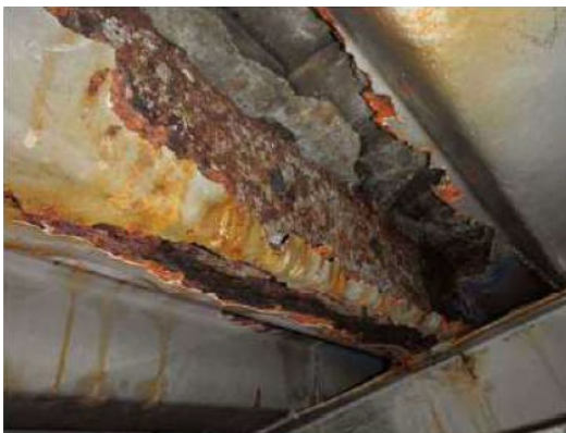
図 1.1.1 歩道橋デッキプレート床版の損傷
