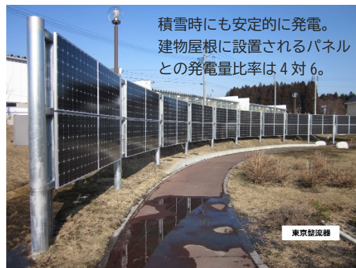
▲垂直設置の設置例(道の駅しちのへ)
