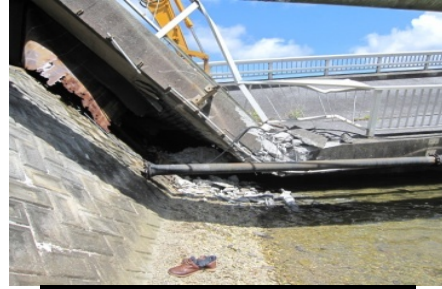
腐食橋の落橋
