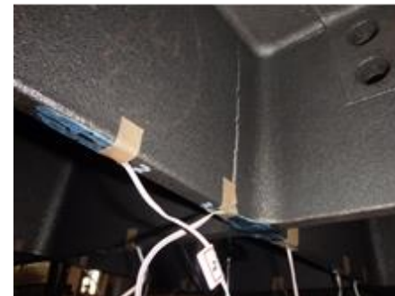
図4. 疲労実験後の供試体
