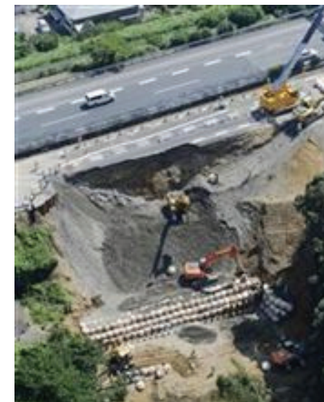
2009年8月11日, 駿河湾地震(M6.5) 静岡県牧之原 東名高速道路のランクD盛土の崩壊
