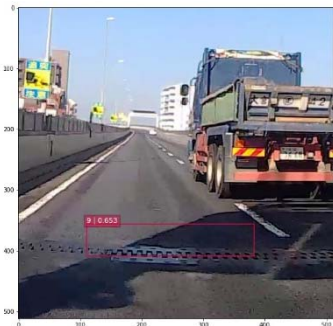
図-27 伸縮装置を検知した様子
