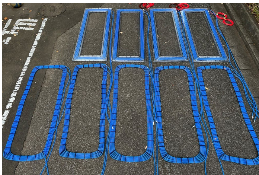
図 53. 土木研究所埋設実験用コイル
