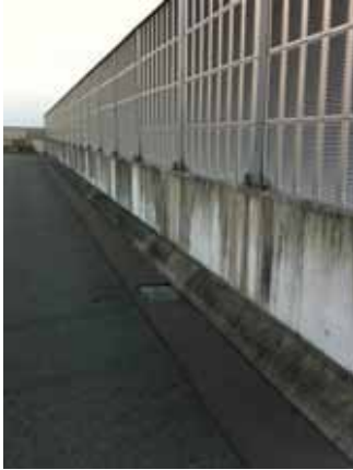
図-7 対象とする壁高欄
