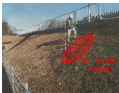
図 2-13 点検時に被災があった道路盛土
