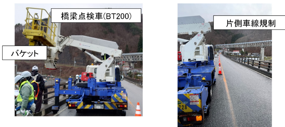
図3-8 (左図) バケット式橋梁点検車BT200。(右図) 片側車線規制の様子
