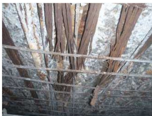
図-5.2 連続ケーブルの破断状況 (第1径間 第8ブロック)
