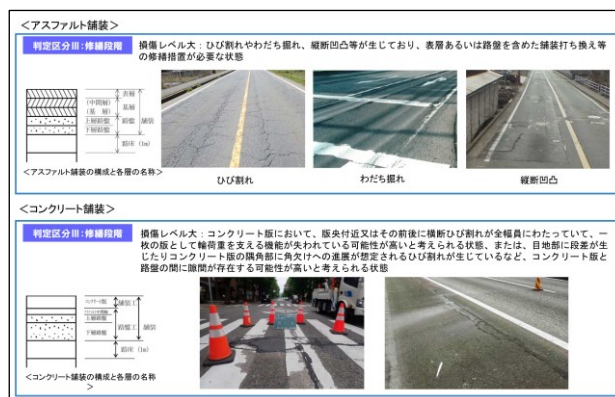
図1.18 舗装の損傷事例
