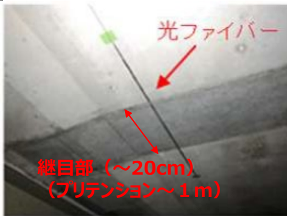
<光ファイバー設置状況>
