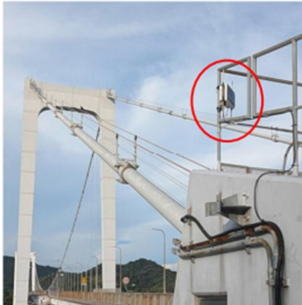
親機 現地設置状況
