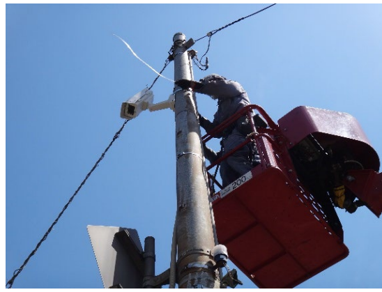
<IPカメラの取付け状況>
