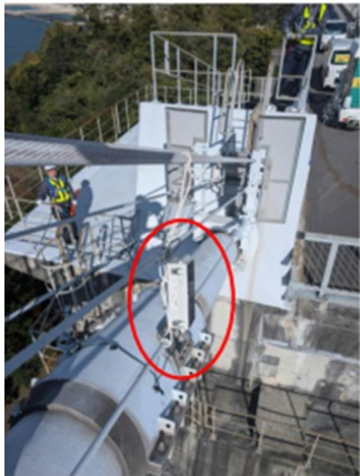
子機 現地設置状況
