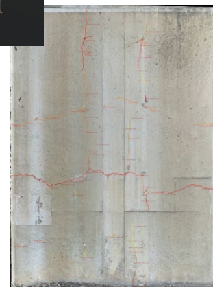
損傷抽出画像
