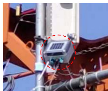
写真-1.4 計測通信端末設置状況
