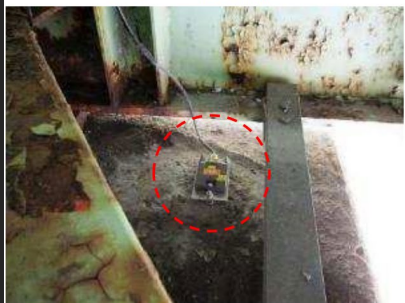
写真-1.3 傾斜計設置状況
