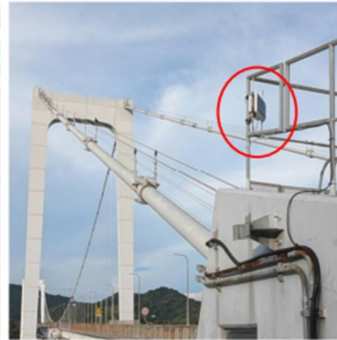
親機 現地設置状況
