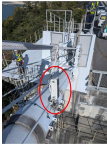
子機 現地設置状況
