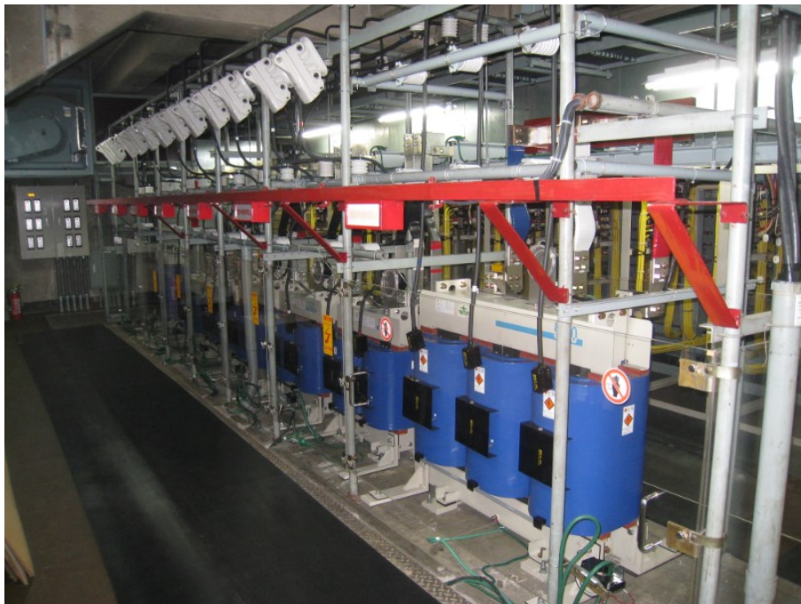
とある庁舎の電気室の様子
