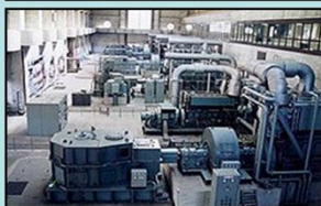
出水対応のために設置された河川用ポンプ及びゲート設備
