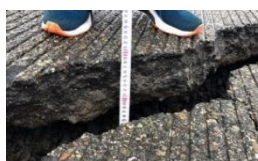
滑走路の被災状況
