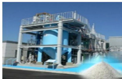
■下水道からのリン回収施設
