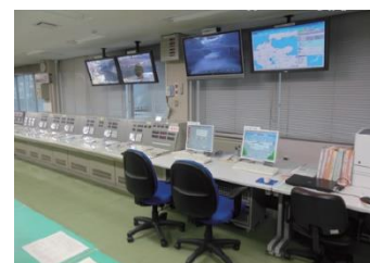
ダム管理システム
