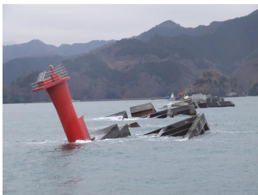
津波により破壊された防波堤
