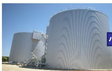
■汚泥消化タンク
