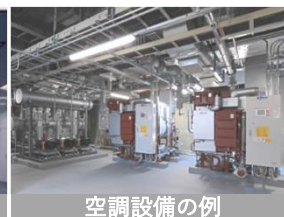
空調設備の例
