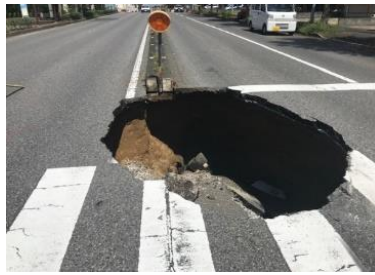
■下水道管の腐食に起因する道路陥没
