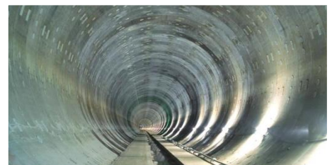
■下水道のハード対策(雨水の排水・貯留施設)
