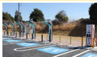
EV充電施設の設置
