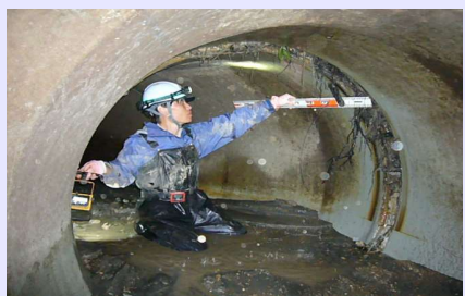
用水路の被害状況調査
