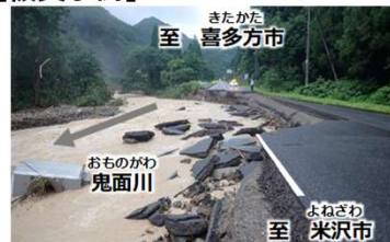
国道121号 令和4年8月の大雨
