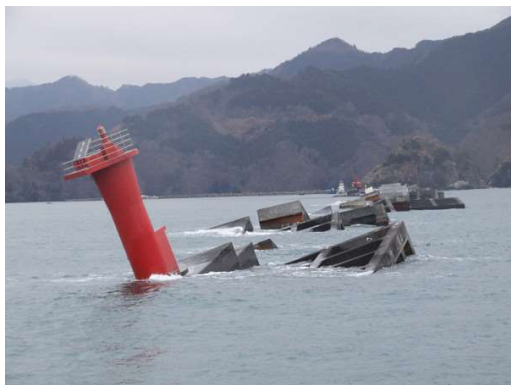
津波により破壊された防波堤
