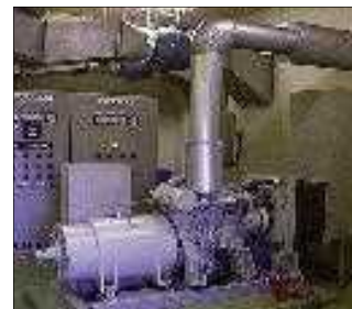
非常用発電機
