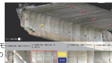
インフラの破損箇所の自動記録
