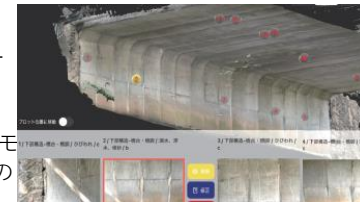
インフラの破損箇所の自動記録
