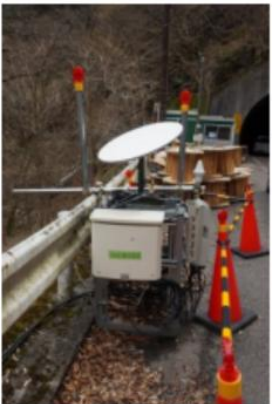
崩落地点に設置した簡易基地局
