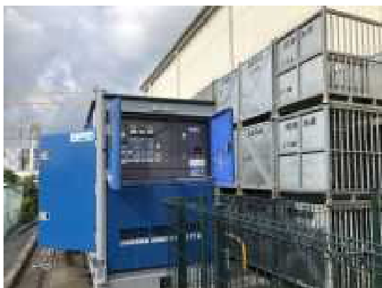
非常用発電機
