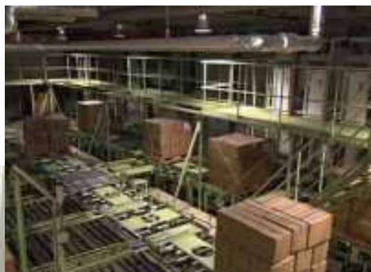
自動ラック倉庫
