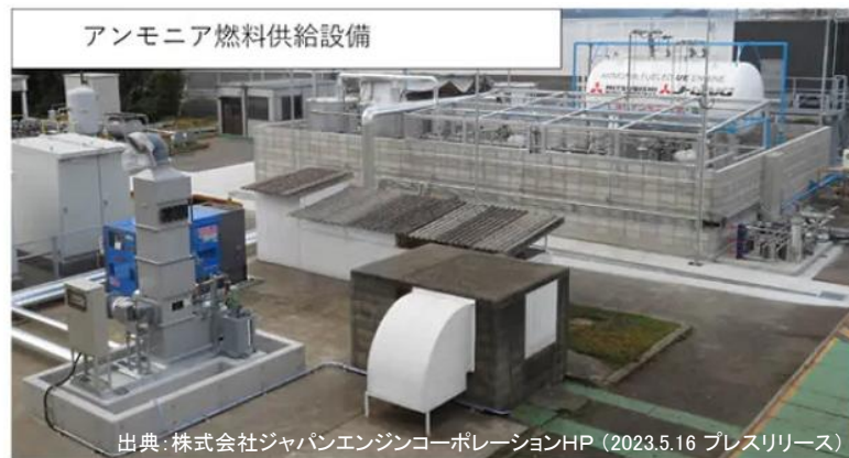
アンモニア燃料供給設備
