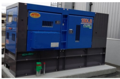
<非常用電源設備>
