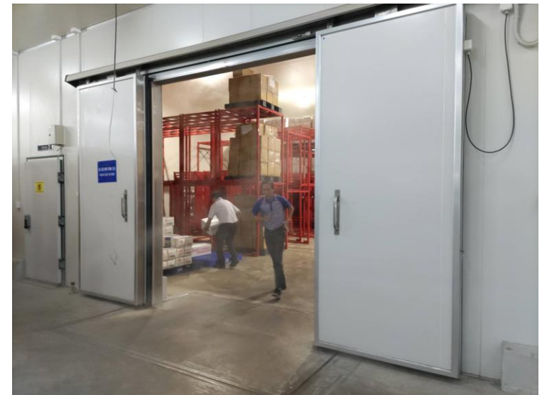
冷凍倉庫(手前は冷蔵)
