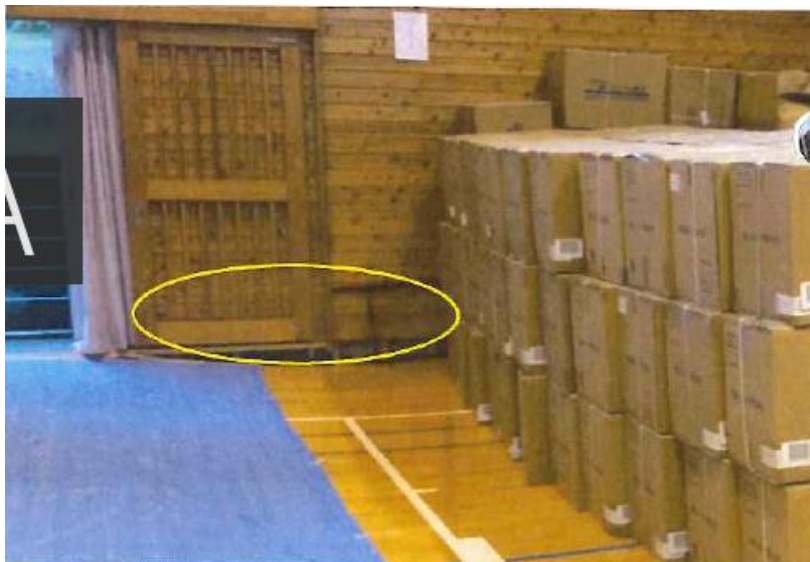
図表Ⅲ－２－１ 支援物資を大量に保管したため床が損壊した体育館（平成 28 年熊本地震）
