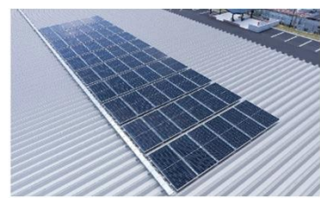
＜屋根に設置した太陽光パネル＞
