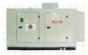
非常用電源設備
